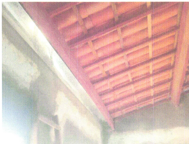
FOTO 03 - TELHAMENTO COM TELHA CERÂMICA CAPA-CANAL, TIPO COLONIAL, COM ATÉ 2 ÁGUAS, INCLUSO TRANSPORTE VERTICAL. AF_07/2019
